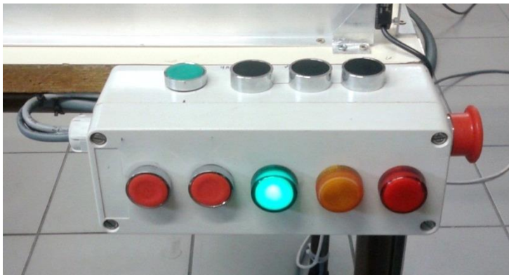
Figura 4-7 Sistema de comando e de sinalização implementado
