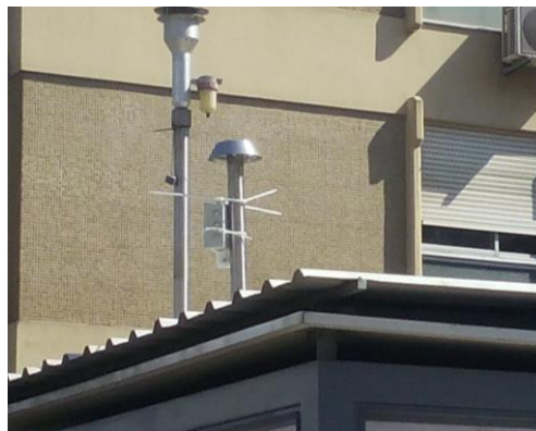
Localização do analisador eletroquímico
