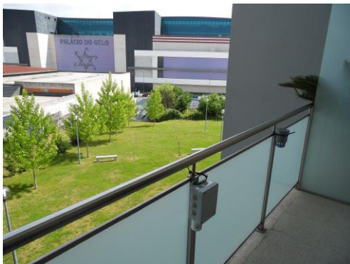
Colocação do tubo de difusão + analisador eletroquímico
