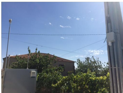
Analisador eletroquímico + estação da qualidade do ar
