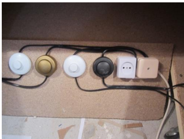
Fig. 10 – Comandos da instalação elétrica
