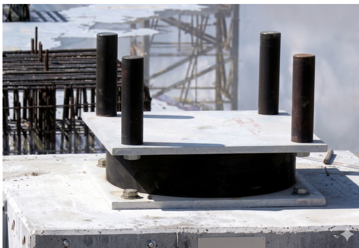
Figura 3.1: Isolador que utiliza o sistema passivo instalado no Hospital da Luz em Lisboa (Guerreiro, 2023)
