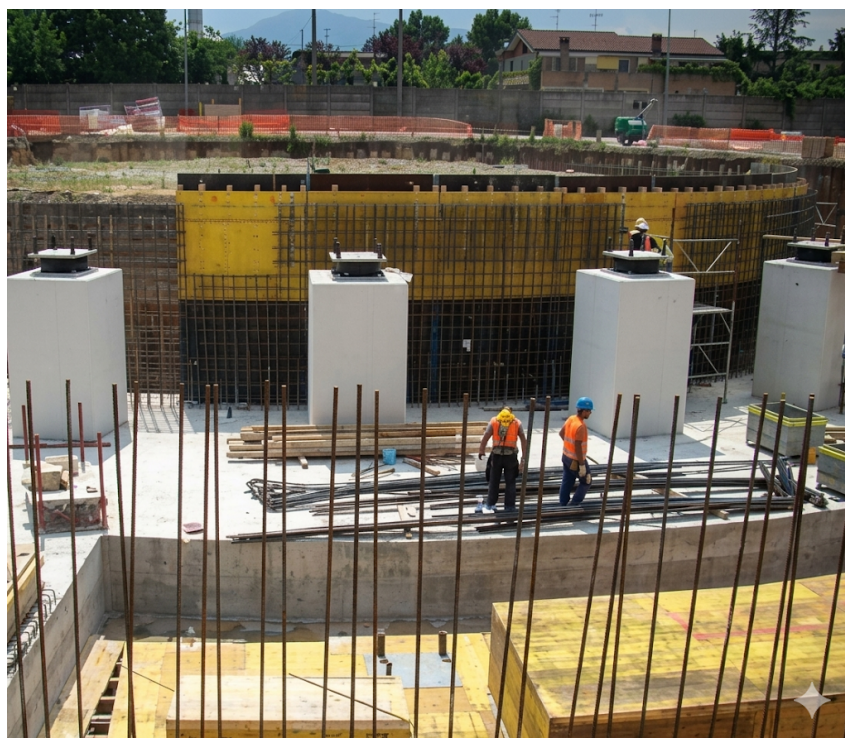
Figura 5.1: Isoladores HDRB implementados na sede da ANAS em L'Aquila (FIP, 2016)
