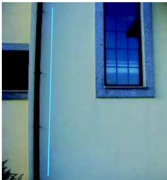
Figura 3-13: Fissura vertical junto ao cunhal
