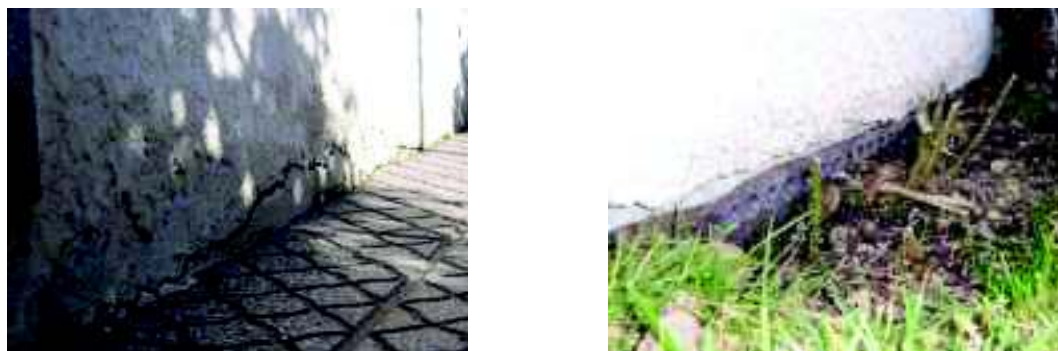
Figura 3-1: Degradação, fissuração e ausência de capeamento do revestimento junto à base
