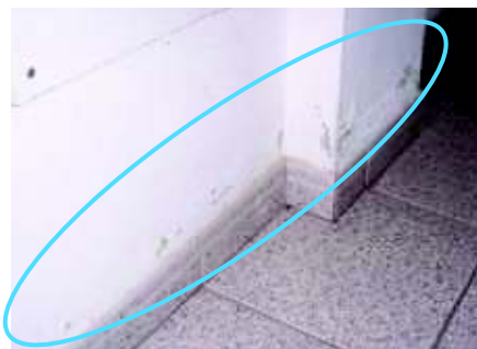
Figura 3-4: Humidade ascensional – parede interior (patologia com cerca de 45 - 55 cm de altura)
