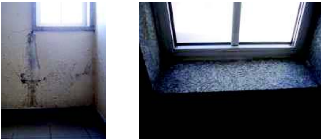
Figura 3-32: Mancha de humidade junto ao peitoril
