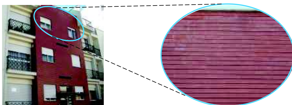
Figura 3-20: Manchas e eflorescências na fachada
