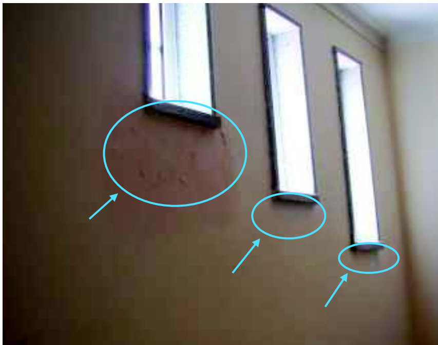
Figura 3-6: Mancha de humidade junto ao peitoril - vista geral interior
