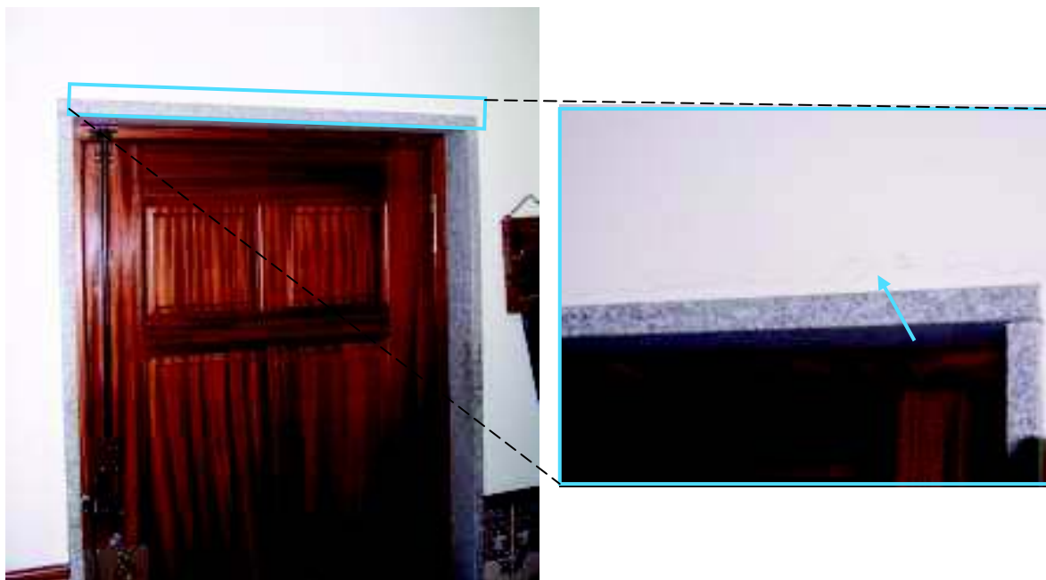
Figura 3-30: Fissuração da torça de uma porta
