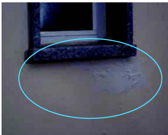
Figura 3-7: Mancha de humidade junto ao peitoril - vista pormenorizada interior
