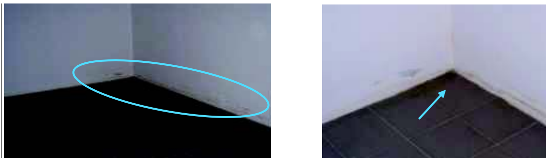
Figura 3-16: Humidade ascensional - empoamento e descolamento da tinta
