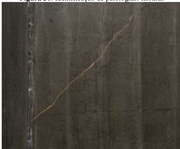
Figura 30: Identificação de patologias: fissuras
