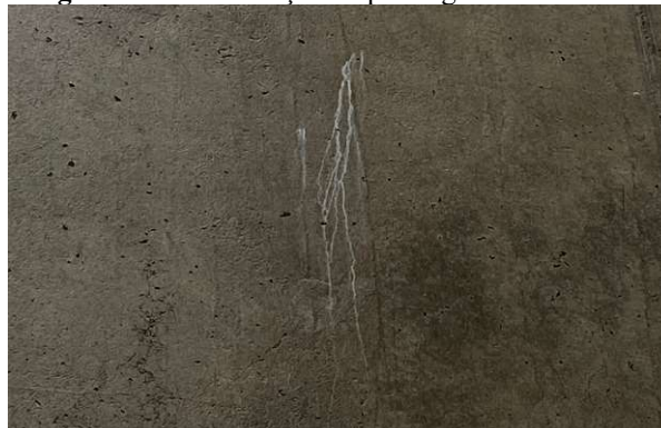
Figura 32: Identificação de patologia: eflorescência
