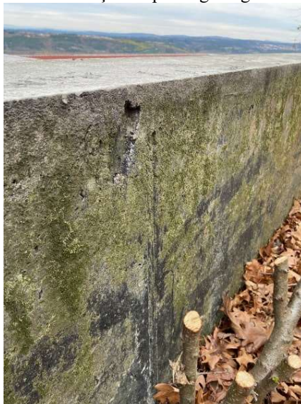
Figura 31: Identificação de patologia: agentes biológicos
