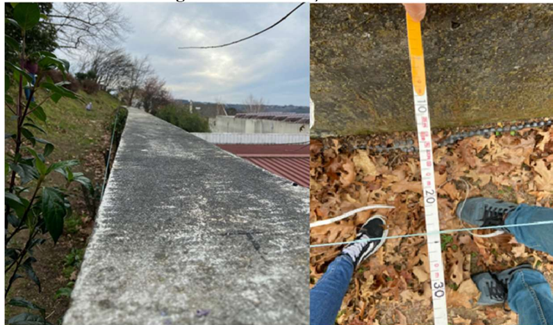
Figura 27: Deformação do muro
