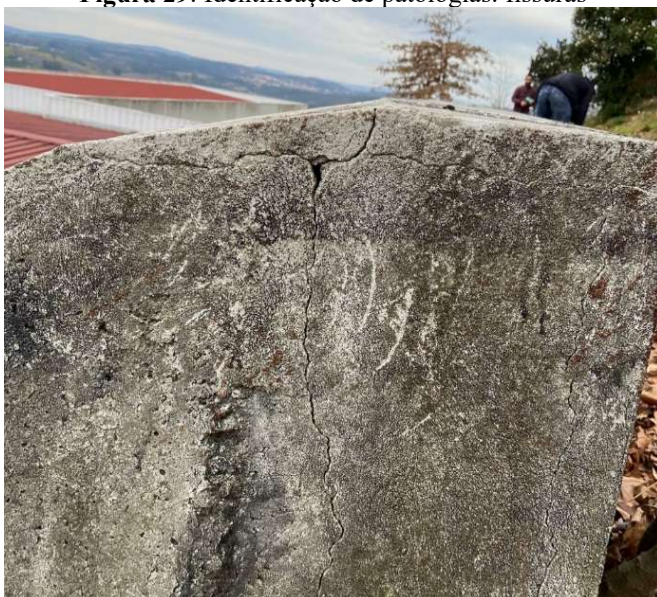
Figura 29: Identificação de patologias: fissuras
