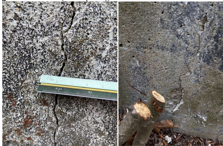
Figura 28: Identificação das patologias: fissuras e descolamento do concreto
