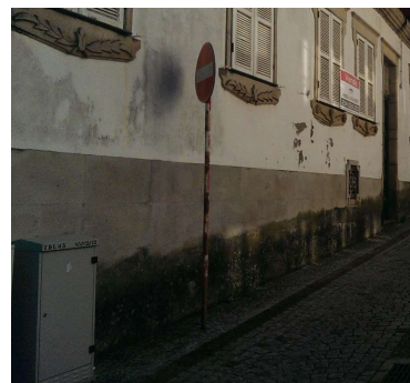
Figura 51 - Orientação errada da sinalização
