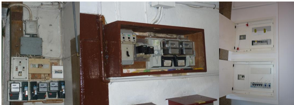
Figura 5-32: Exemplos de quadros elétricos antigos com disjuntores diferenciais (à esq.) e quadro elétrico novo (à dir.)
