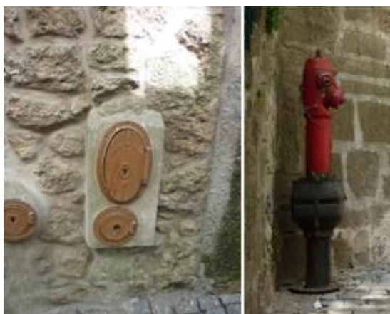
Figura 2-7: Hidrantes exteriores (Rua Escura)
