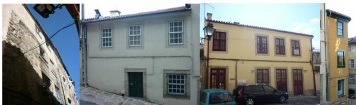
Figura 5-17: Edifícios que correspondem a um estado de conservação de grau 2, 3, 4 e 5, da esq. para a dir. respetivamente
