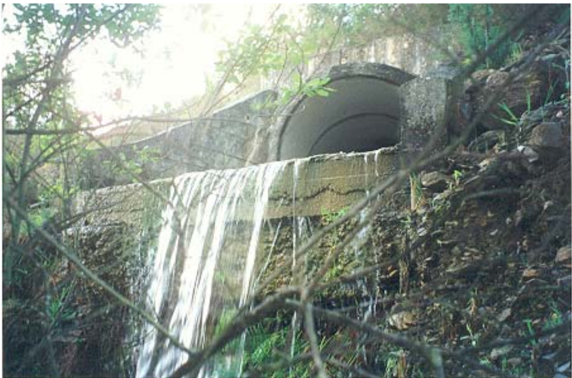
Figura C14 – Efeitos da ausência de dissipador de energia num aqueduto de secção circular.
