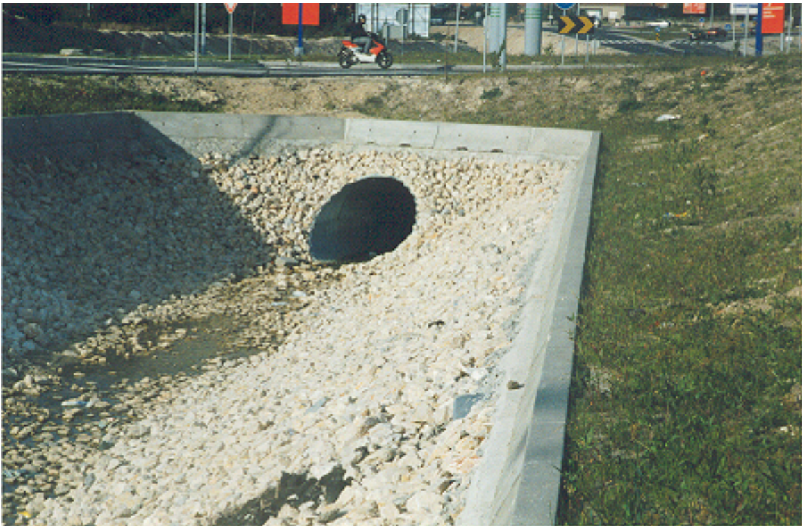
Figura C6 – Aqueduto em tubo metálico corrugado ( corrugated pipes ).
