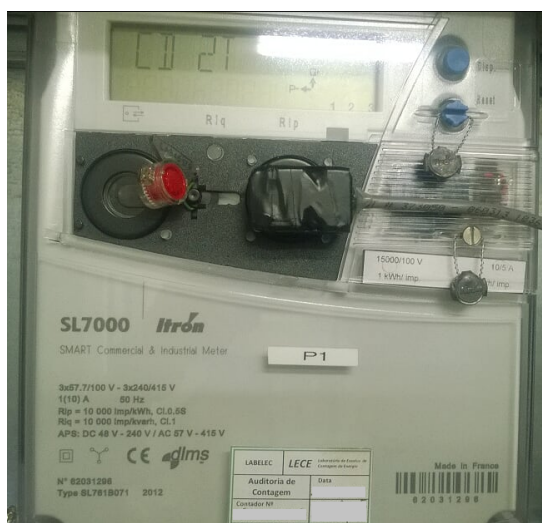
Figura 5-3: Detetor de pulsos de luz aplicado no contador de energia.
