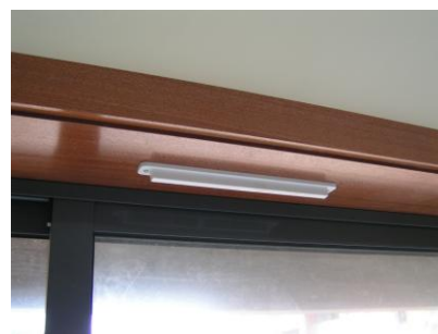
b) Grelha auto-regulável instalada nos quartos e sala
