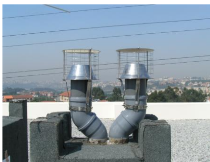
a) Ventilador estático na conduta da instalação sanitária
