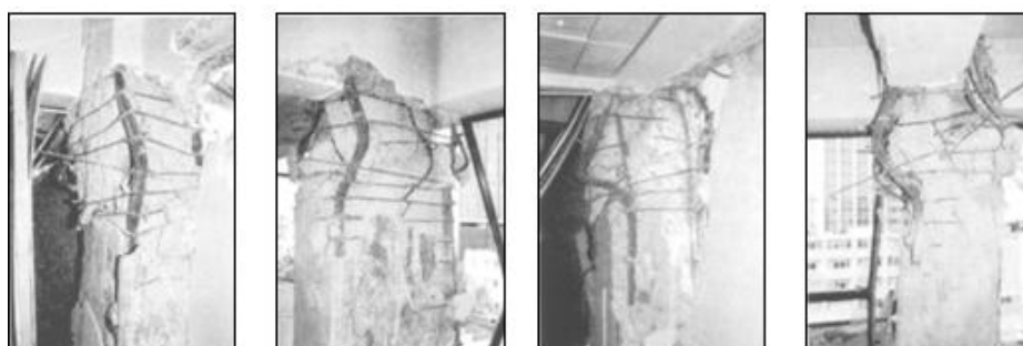
Figura 2-21: Efeito dos sismos em pilares de betão armado (Tesoro, 2001).
