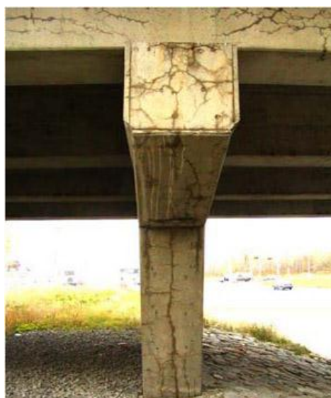
Figura 2-5: Reação alcali-silica num pilar (Watt, et al., 2003).
