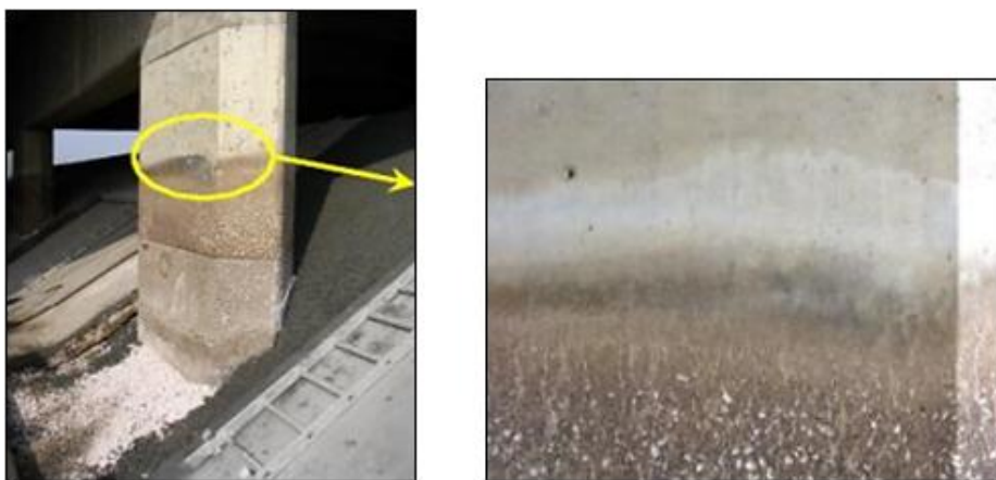
Figura 2-10: Pilar de uma ponte afetado pelo ataque de águas puras (Appleton e Costa, 2009).
