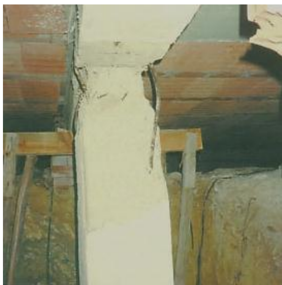
Figura 2-14: Rotura de um pilar mal executado (Souza e Ripper, 2009).
