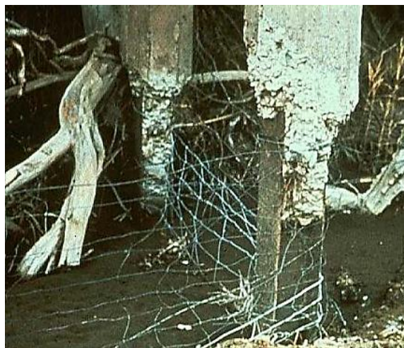
Figura 2-7: Pilares degradados por ataque de sulfatos (Hooton, 2011).
