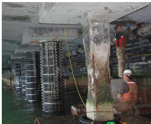
Figura 2-1: Corrosão provocada por ataque de cloretos (Trindade, 2011).
