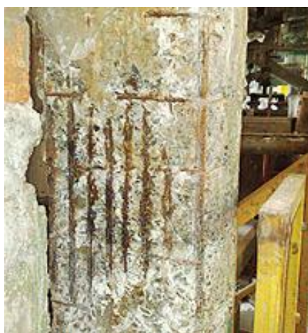
Figura 2-9: Pilar pertencente a uma indústria têxtil, danificado pelos químicos usados no branqueamento dos tecidos (Medeiros, 2010).
