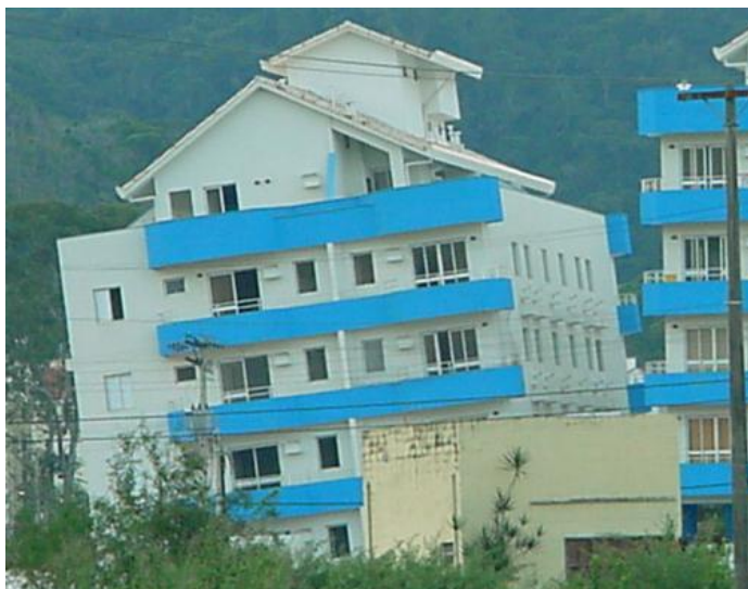
Figura 2-17: Assentamentos diferenciais de um edifício (Thomaz, 2011).
