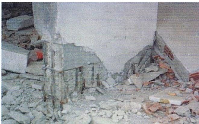
Figura 2-16: Rotura por flexão de um pilar (Tesoro, 2001).
