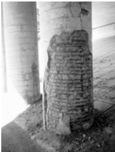
Figura 2-15: Pilar sujeito a vários ciclos gelo-degelo (Cemex Deutschland AG, 2011).
