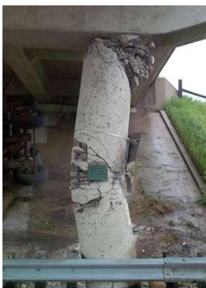
Figura 2-19: Pilar danificado pelo impacto de um veículo (Mn/DOT, 2011).
