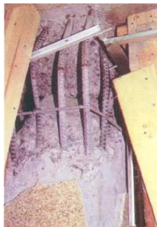
Figura 3-12: Rotura da ligação viga-pilar (Tesoro, 2001).
