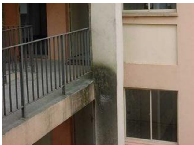
Figura 2-11: Presença de musgos em pilar (Thomaz, 2011).
