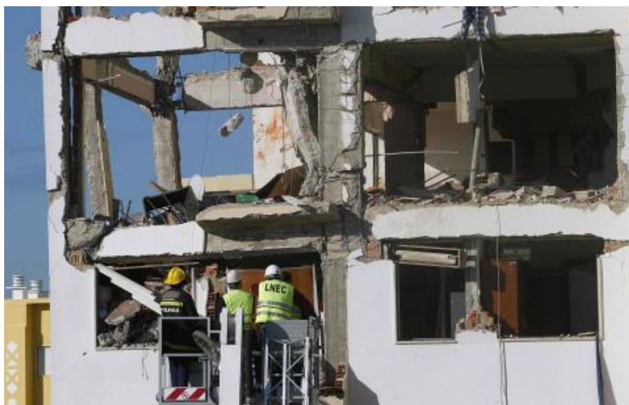
Figura 2-18: Explosão de gás num edifício em Setúbal (Granado e Louça, 2010).
