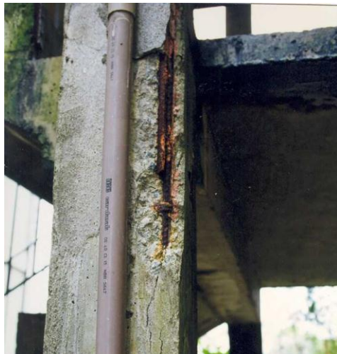
Figura 2-3: Corrosão provocada por carbonatação (Watt, et al., 2003).
