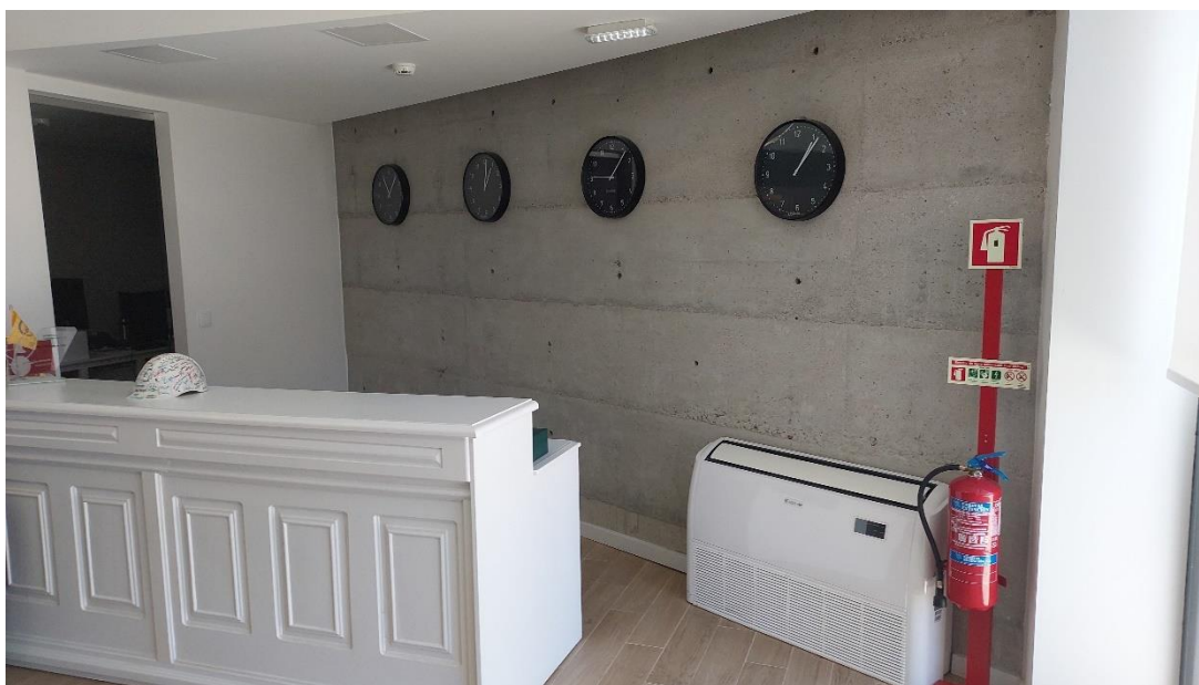
Figura 21 - Equipamento de ar-condicionado na recepção
