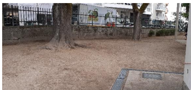
Figura 4: Irregularidade no piso na Escola da Avenida
