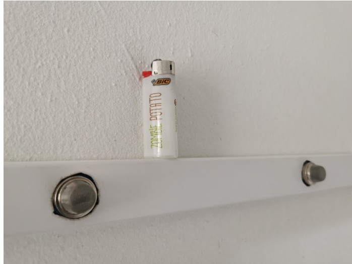
Figura 24 - Sensores MQ-6 instalados no espaço da caldeira
