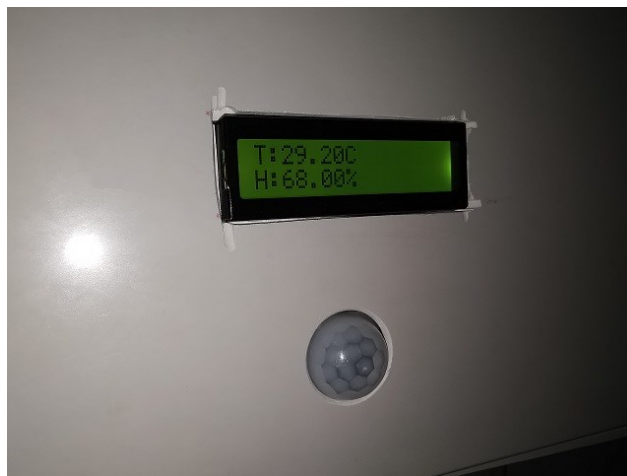
Figura 23 - Sensor PIR instalado no espaço da Casa das Máquinas
