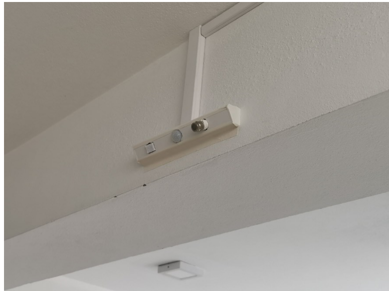
Figura 17 - Sensores instalados no hall da Recepção
