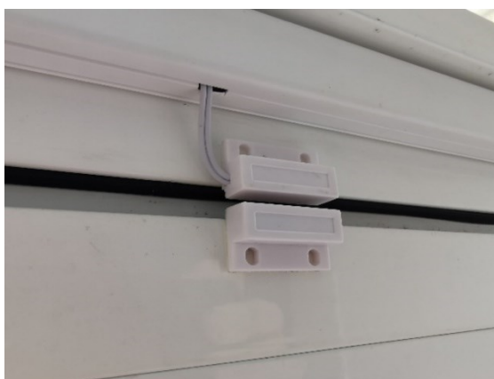
Figura 12 - Sensor MC-38 instalado na porta de acesso à Receção
