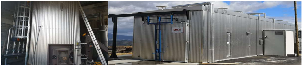
Figura 9 - Unidade de tratamento térmico (caldeira e secador)
