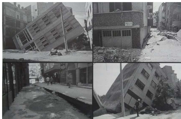
Figura 2.1: Fenómeno de liquefação. Liquefação do solo na Turquia em 1999 (Lopes, 2008).
