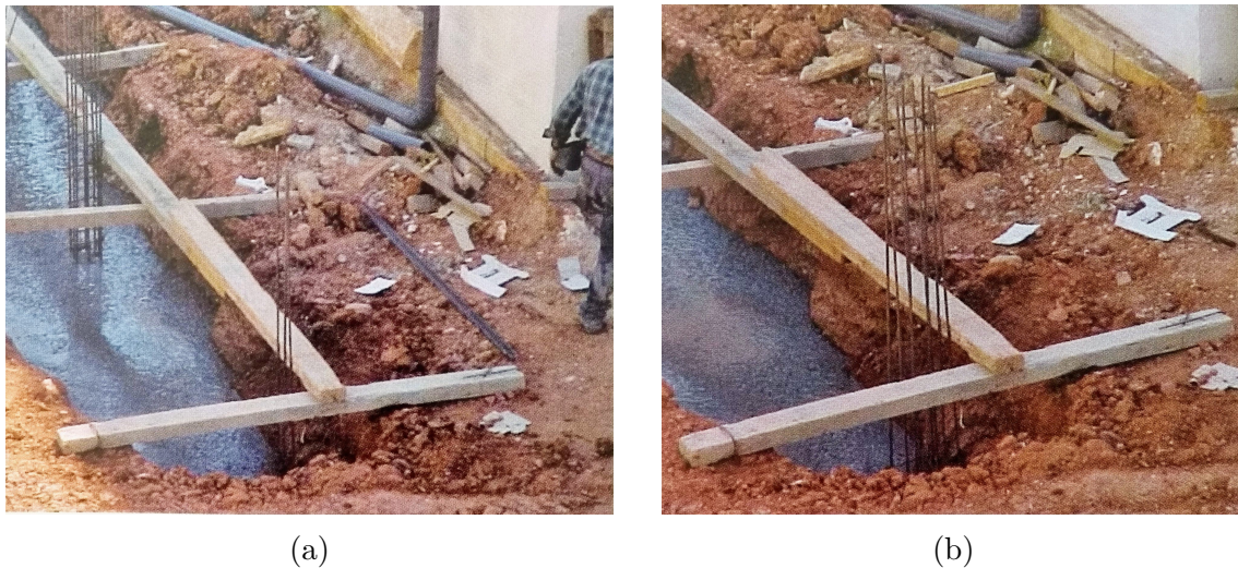
Figura 2.4: Sequência defeituosa da execução de uma fundação (Lopes, 2008): (a) Cravação de varões de aço na fase inicial de secagem do betão; (b) Processo final.
