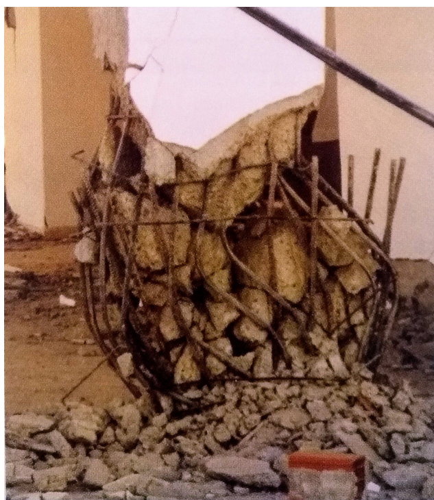
Figura 2.9: Cintagem deficiente - encurvadura por flexão das armaduras verticais por compressão e perda de material (Lopes, 2008).
