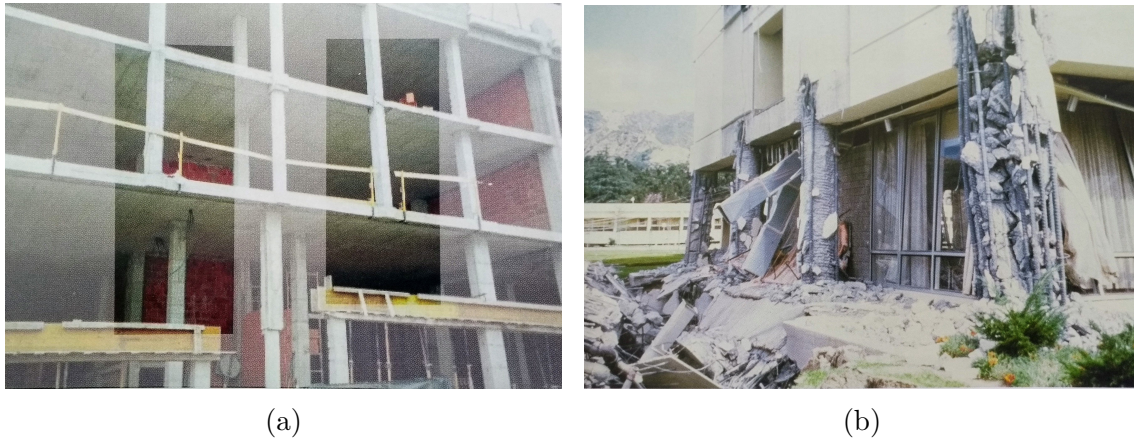
Figura 2.6: Interrupção ou enfraquecimento do sistema estrutural (Lopes, 2008): (a) Interrupção de elementos estruturais verticais; (b) Danos num edifício com menos paredes no piso térreo.
