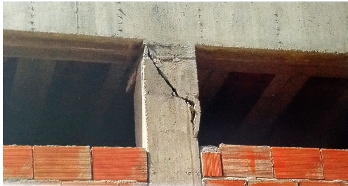
Figura 2.7: Formação de coluna curta devido à falta de preenchimento da alvenaria até ao topo (Lopes, 2008).
