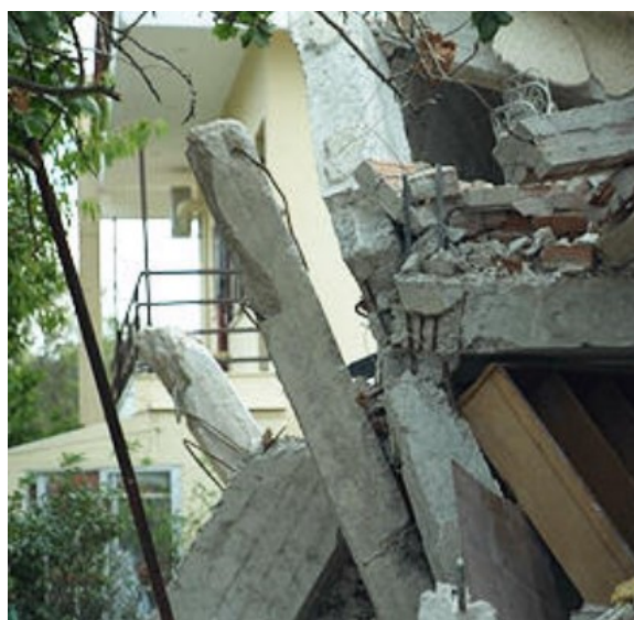
Figura 2.5: Colapso de uma zona crítica do tipo ligação viga/pilar (Decanini et al., 2002).
