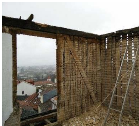
Figura 11: Parede de tabique exterior com frechal em castanho do Ed.1 (Fernandes C., 2016)
