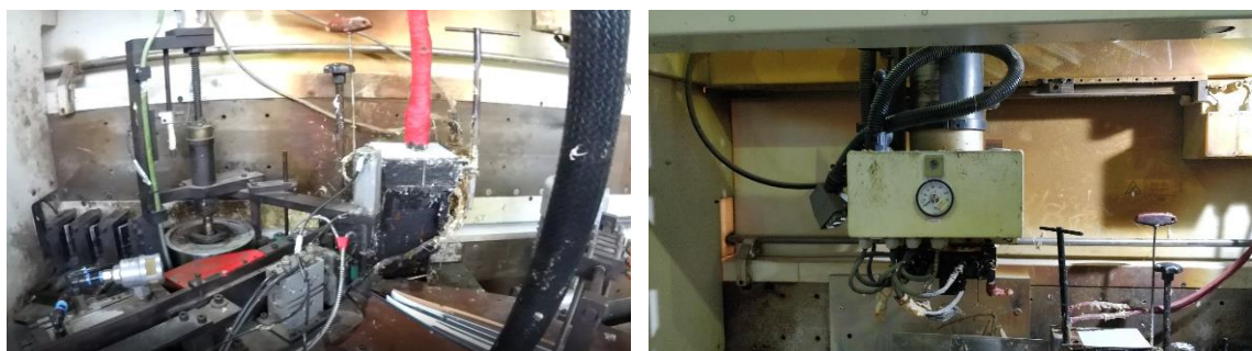
Figura 13 – Sistema de colagem Orladora Combima
