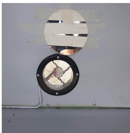
Figura 19 - Entrada de ar do secador e ventilador de insuflação
