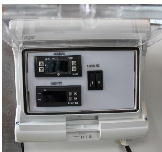
Figura 22 - Painel de controlo do secador
