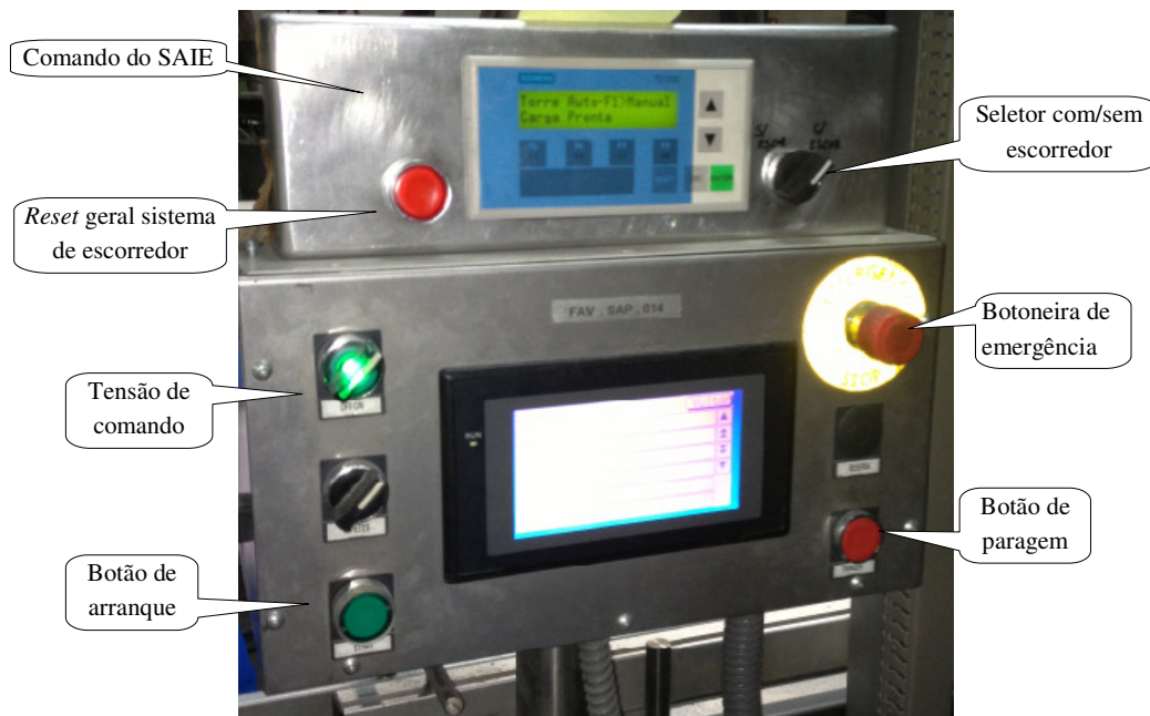
Figura 3.7. Painel de operação
