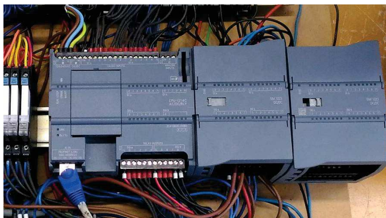
Figura 3.25: PLC instalado na célula.
