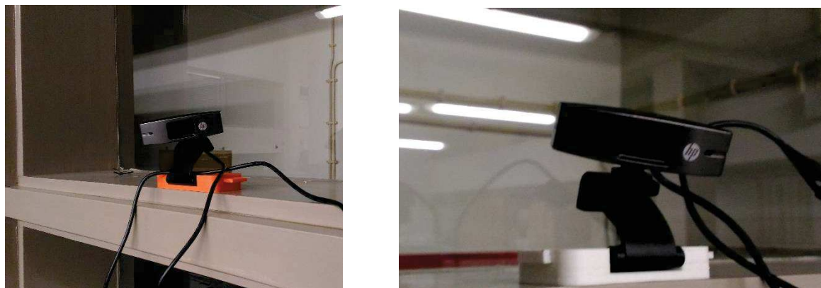
Figura 3.30: Câmaras instaladas na célula.
