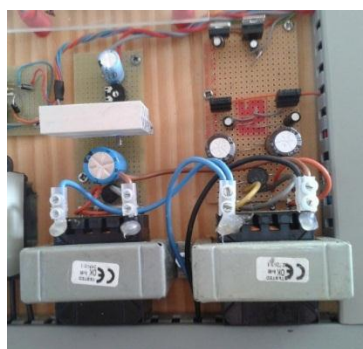
Figura 4-18: Detalhe de montagem fontes de tensão regulada.
