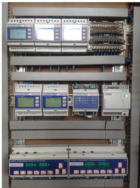
Figura 3-26: SGE implementado e instalado na plataforma desenvolvida.
