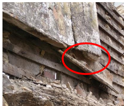
b) Argamassa terrosa sob a telha
