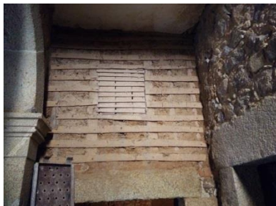
a) Transição alvenaria-tabique (Piso 0)
