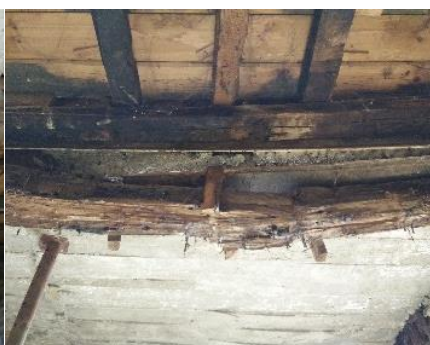
d) Pormenor da cedência da viga de madeira
