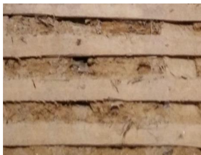
a) Revestimento do tabique mais antigo
