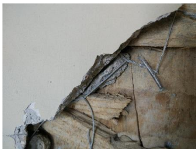
Figura 2-12: Tabique revestido com argamassa de cimento aderida com malha de galinheiro
