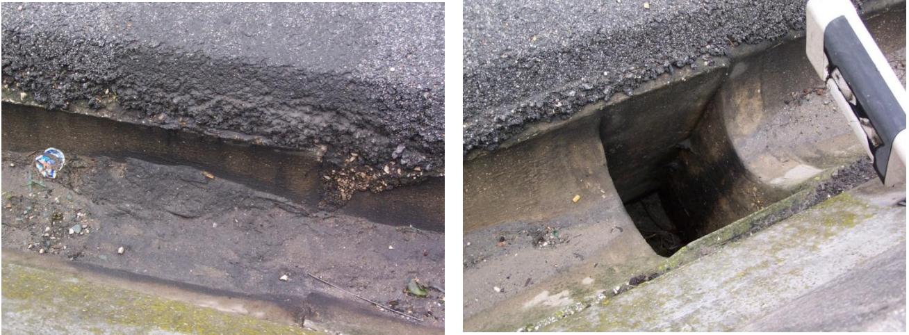
Figura 7-1 – Sólidos sedimentados nas valas de AEE a montante da conduta onde são realizadas as amostragens no caso em estudo – A25 perto de Aveiro, no âmbito do projeto G-Terra. a) pormenor dos sólidos sedimentados; b) poço de receção das AEE das valas, a montante da conduta.
