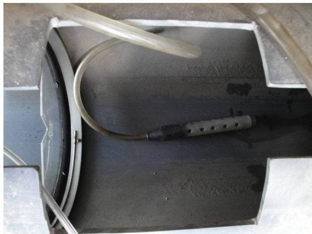
Figura 6-2 – Pormenor do posicionamento do filtro de sucção na conduta, vista de cima. (Fonte: fotografia tirada no ponto de amostragem A25, no âmbito das amostragens realizadas no projeto G-Terra).
