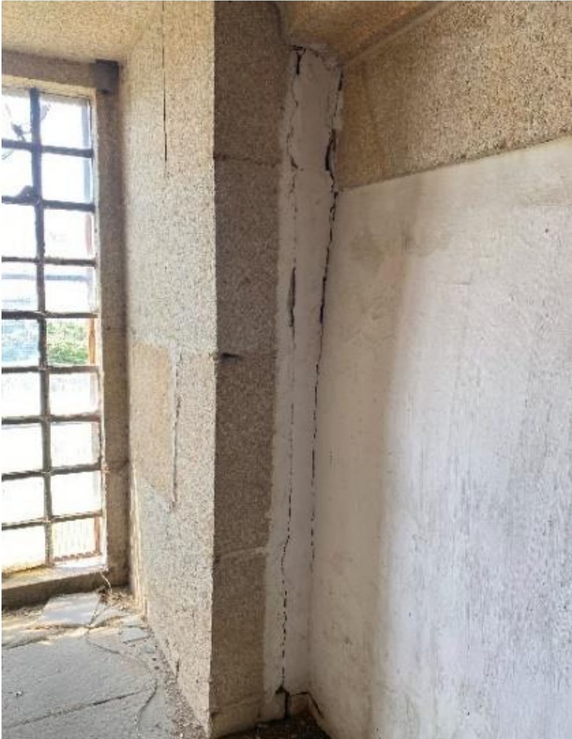
Fotografia 2 – Localização: Ligação Interna entre a Parede Frontal e a Parede Lateral Esquerda
