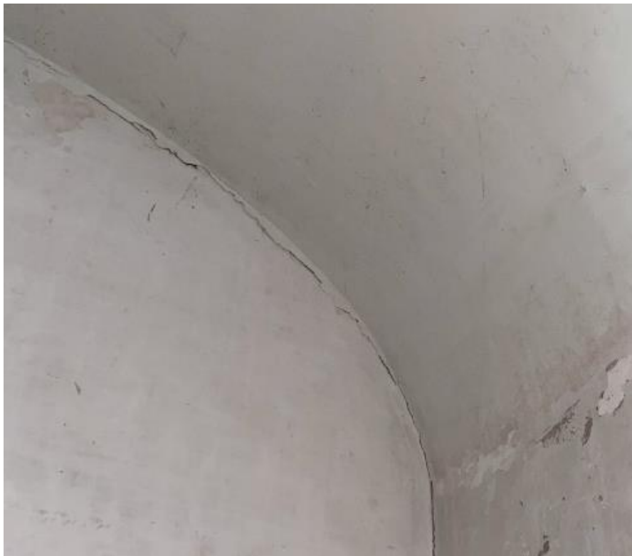
Fotografia 23 – Localização: Parede Frontal (interna) por baixo do Coro
