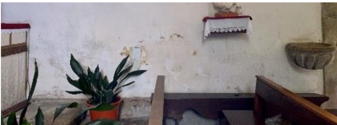
Fotografia 33 - Localização: Parede Lateral Direita (interna) da Nave
