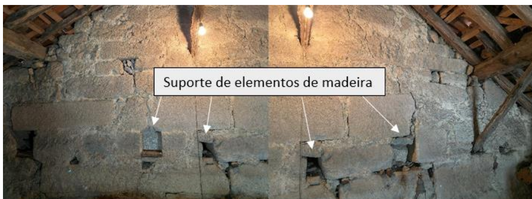
Figura 43 – Parede da capela-mor e sacristia com entalhes para apoio de elementos de madeira
