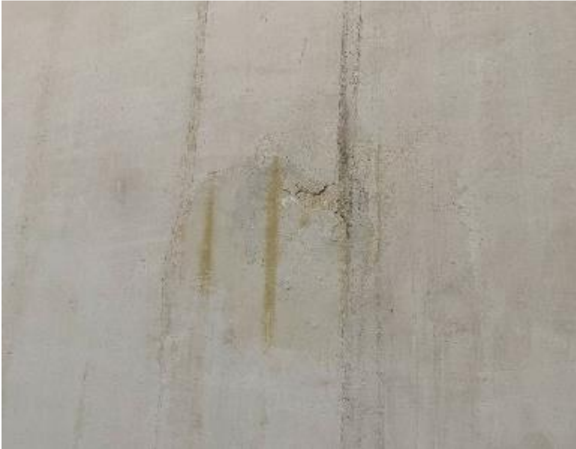
Fotografia 30 – Localização: Parede Lateral Direita (interna) da Nave
