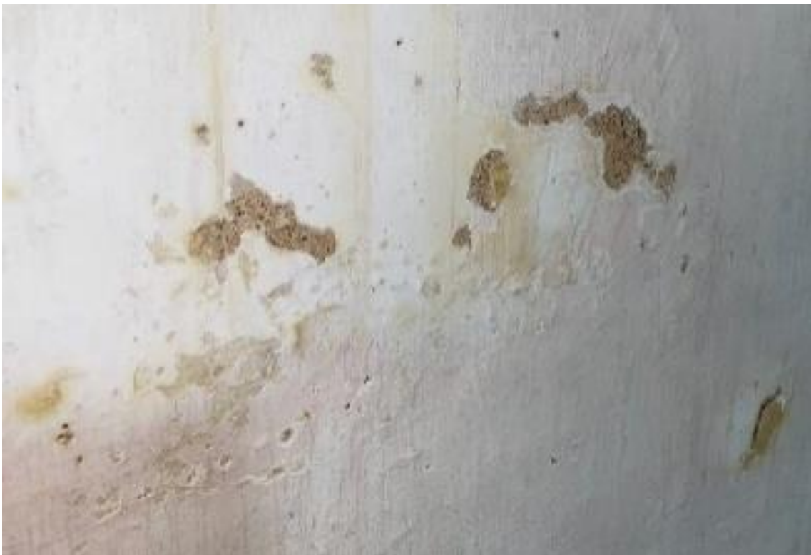
Fotografia 31 – Localização: Parede Lateral Direita (interna) da Nave
