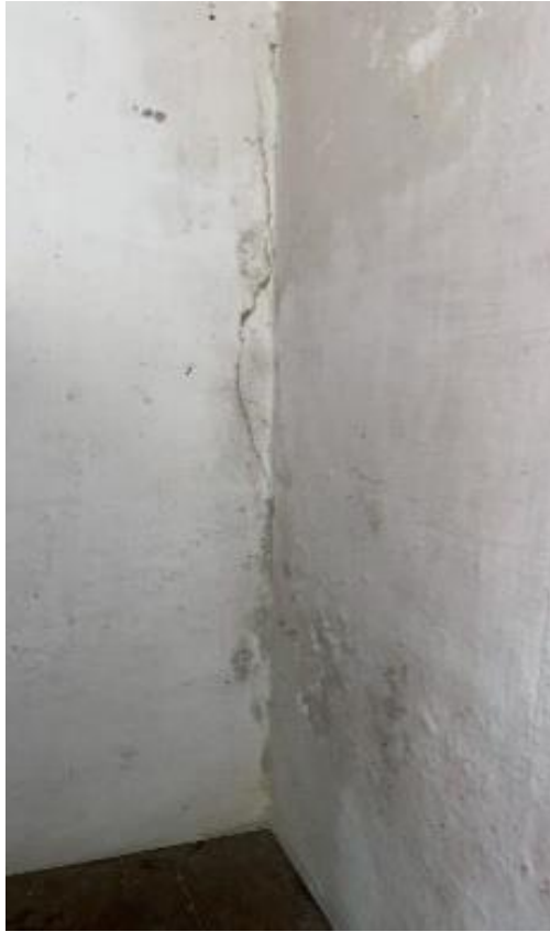
Fotografia 24 – Localização: Parede Frontal (interna) por baixo do Coro
