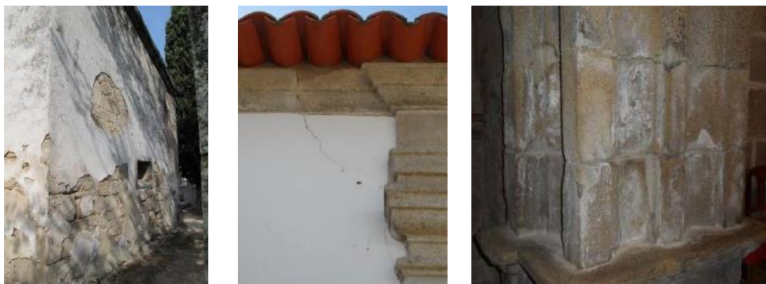
a) Perda de argamassa
