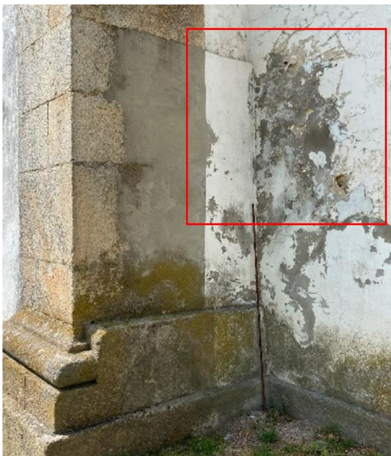
Figura 80 –Exemplo selecionado para ilustrar uma perda de argamassa
