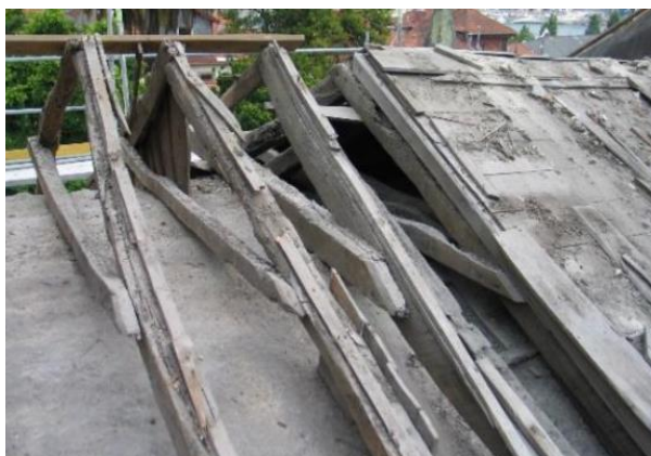
Figura 17 – Exemplo de degradação em madeira (Vilela, 2019)
