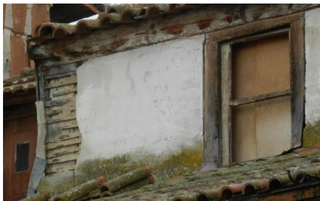
Figura 18 – Perda de argamassa em parede de tabique (Pinto, 2015)
