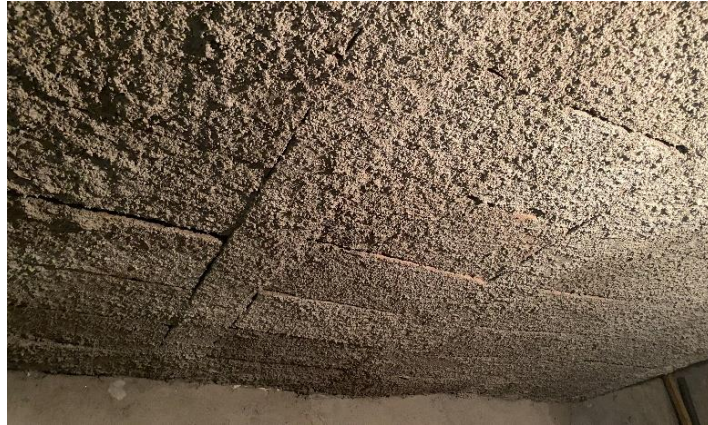
Figura 41 – Pormenores da face inferior do pavimento do segundo piso
