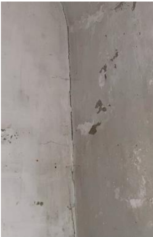
Fotografia 25 – Localização: Parede Frontal (interna) por baixo do Coro
