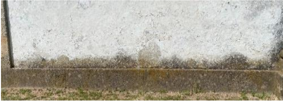
Figura 78 – Exemplo selecionado para ilustrar uma mancha de humidade
