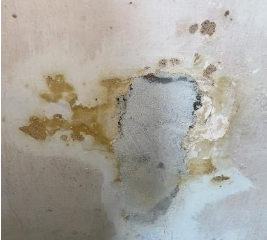
Fotografia 32 – Localização: Parede Lateral Direita (interna) da Nave
