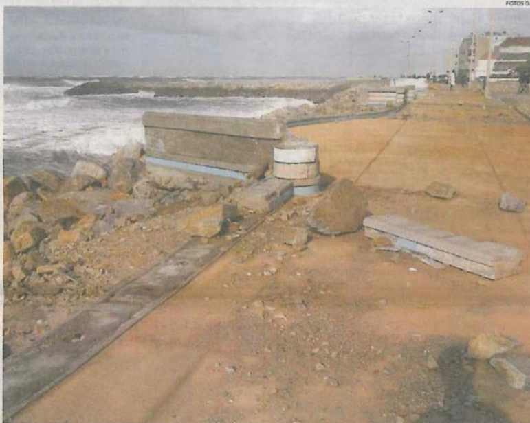
As águas têm derrubado as barreiras protectoras
