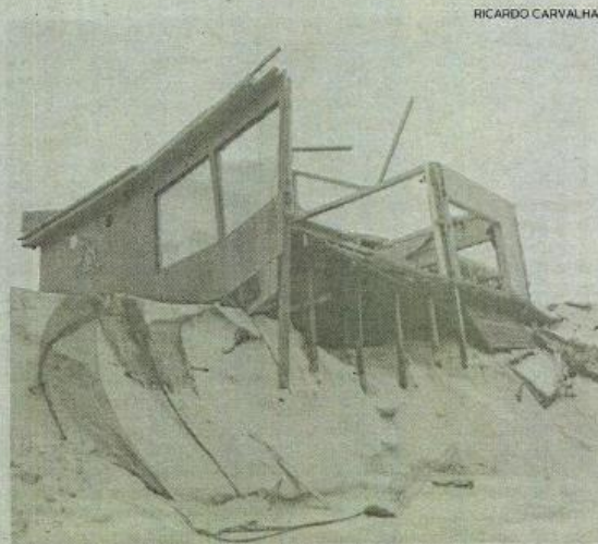
Restaurante foi destruído pela força das ondas
