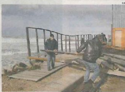
O avanço do mar provocou vários estragos no Furadouro
