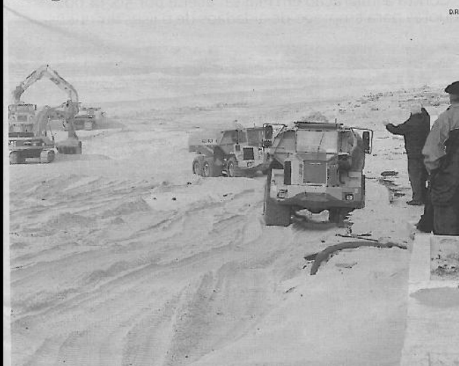
Máquinas estão, há duas semanas, a colocar areia para travar o avanço do mar
