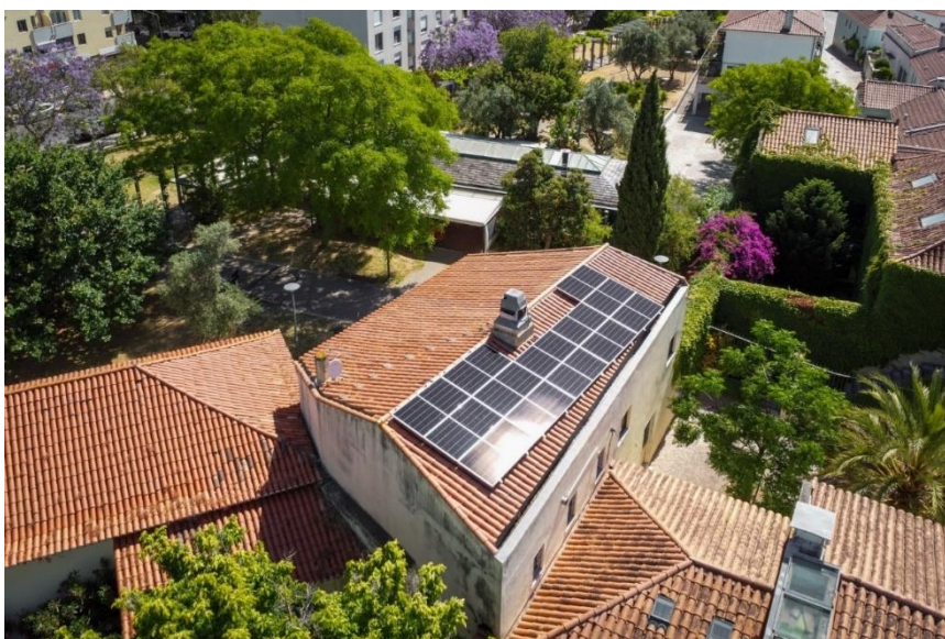
Figura 3 - Módulos Fotovoltaicos Instalados na Comunidade Energética Renovável (CER) de Telheiras (Fonte: [20])
