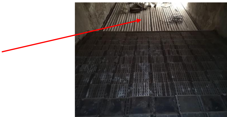
Figura 23 - Sistema de vibração de grelha
