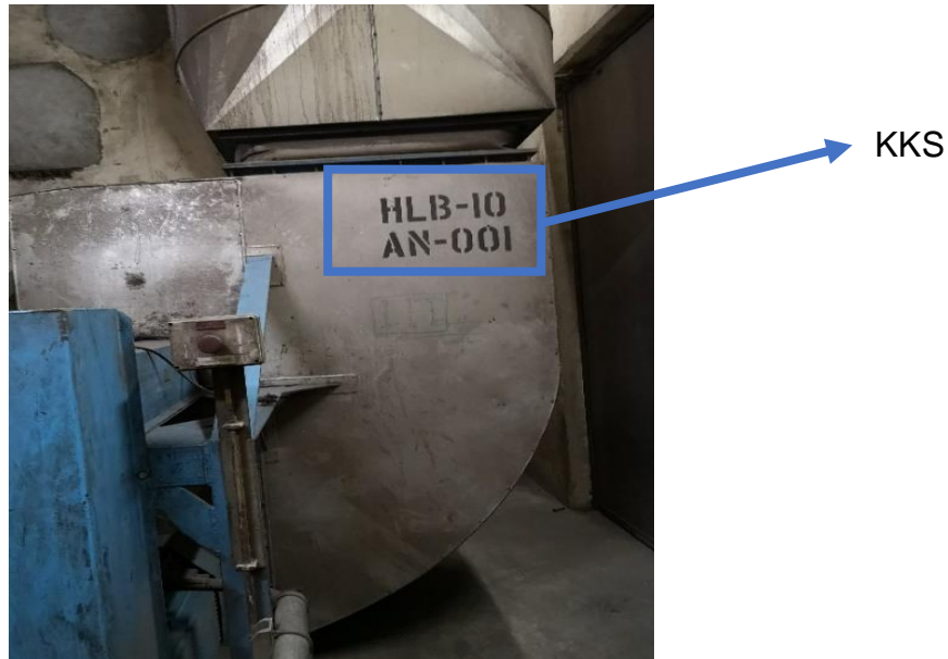
Figura 25 - Exemplo do KKS no equipamento
