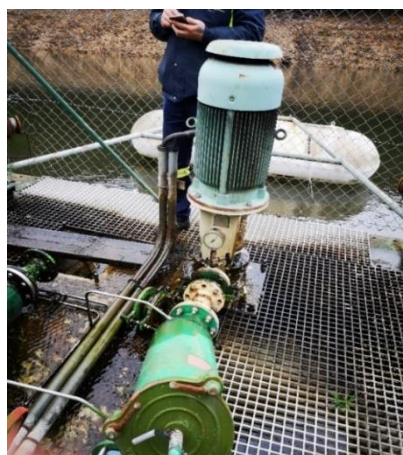
Figura 19 - Bombas de captação de água
