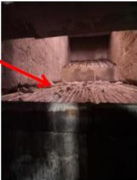
Figura 3 - Atual sistema de vibração de grelha
