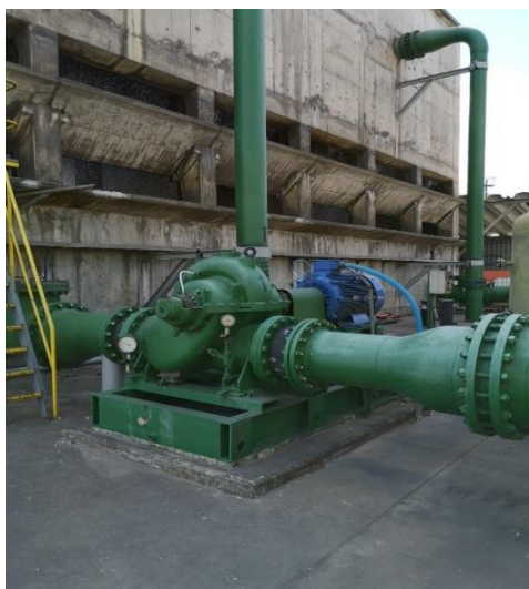
Figura 18 - Bombas de recirculação à torre
