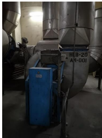
Figura 21 - Ventilador de ar secundário
