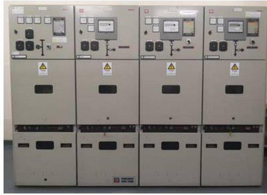
Figura 15- Disjuntor MT do alternador
