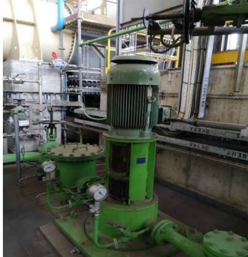
Figura 17 - Bombas de extração de condensados
