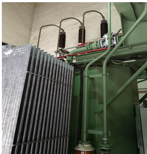
Figura 14 - Transformador de potência
