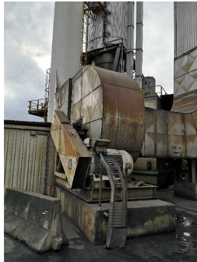
Figura 22 - Ventilador de tiragem induzida
