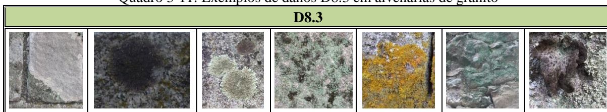
Quadro 3-11: Exemplos de danos D8.3 em alvenarias de granito
