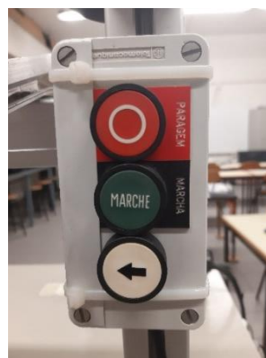
Figura 3-18: Botoneira do setor de armazenamento.
