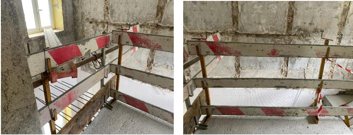
Figura 31 – Guarda corpos instalados em uma plataforma elevada
