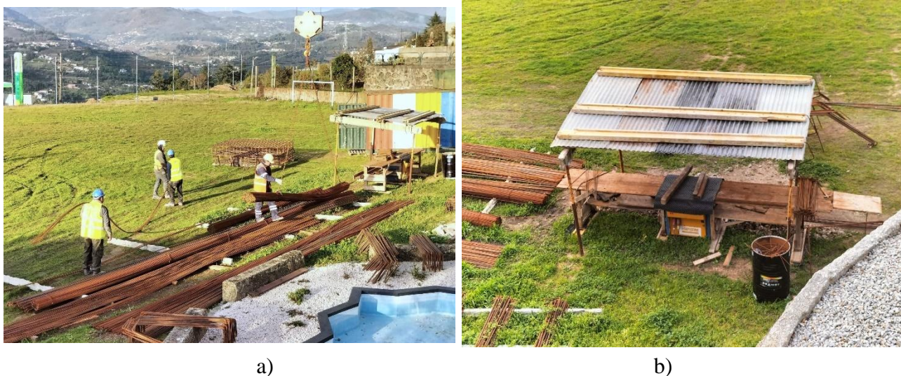
Figura 19 – a) Trabalhadores a manusear os varões de aço e armaduras no estaleiro; b) Organização do estaleiro de aço e armaduras, com áreas de armazenamento e fabrico
