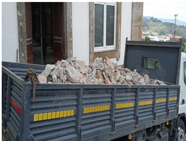
Figura 35 - Transporte de RCD, corretamente armazenados e destinados à valorização de materiais inorgânicos
