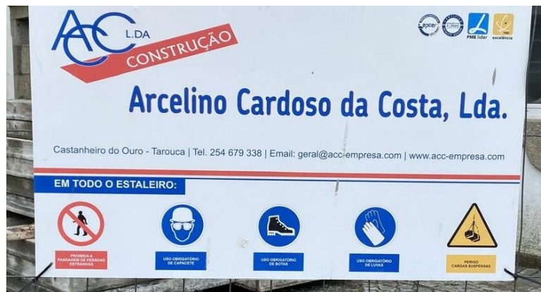
Figura 30 – Sinalização de segurança, incluindo sinais de alerta, proibição, obrigatoriedade e perigo
