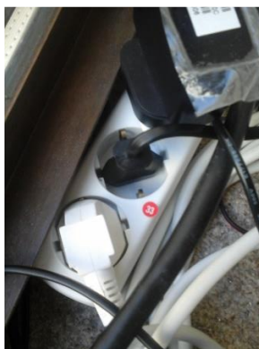
Figura 127. Numeração de uma das tomadas elétricas
