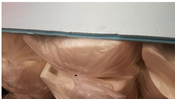
Figura 33 - Roofmate mal posicionado
