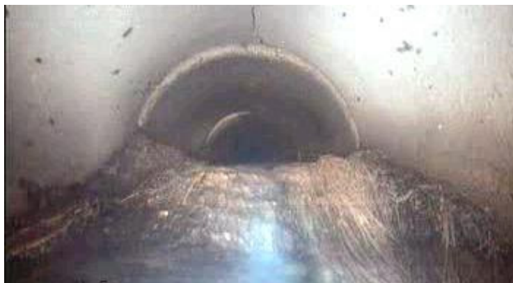
Figura 2.3: Fotografia ilustrativa de um coletor com infiltração de raízes.
