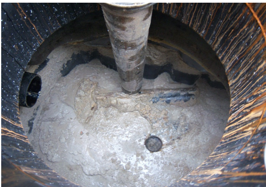
Figura 6.3 – Figura representativa da aspiração de gorduras de uma camara de retenção de gorduras.
