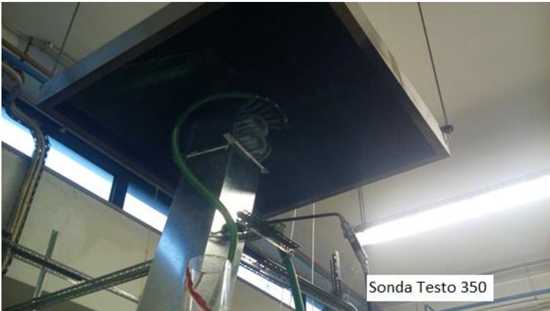
Figura 50: Instalação experimental do permutador.
