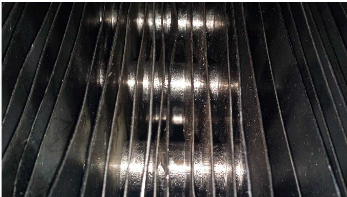
Figura 57: Permutador em operação, vestígios de condensação e incrustações (3).
