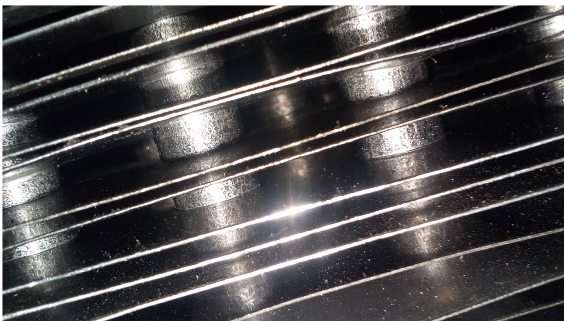
Figura 56: Permutador em operação, vestígios de condensação e incrustações (impurezas e cinzas) (2).
