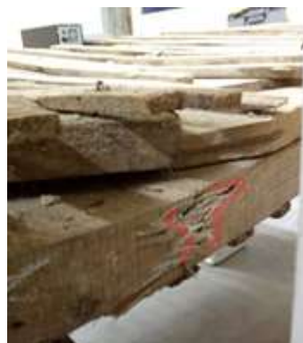
b) Rotura das tábuas
