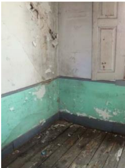
Figura 5.44: Apodrecimento do interior de um edifício por humidade excessiva
