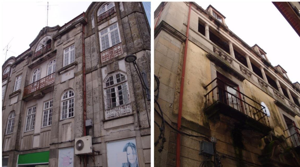
Figura 4.6: Edifícios em pré-ruína
