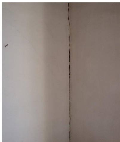
Figura 2.53: Fissura entre paredes
