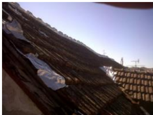
Figura 2.4: Desalinhamento das telhas por empenamento
