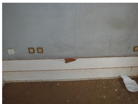
Figura 2.60: Degradação do revestimento do rodapé
