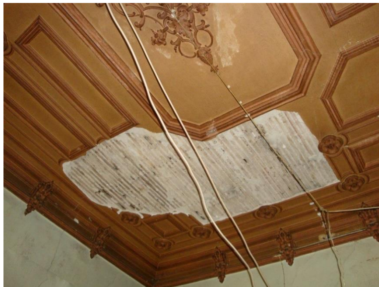
Figura 5.47 - Descasque do reboco
