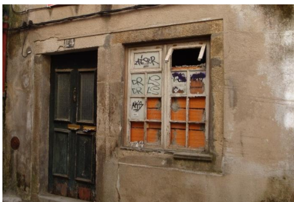
Figura 2.30: Fratura dos vidros
