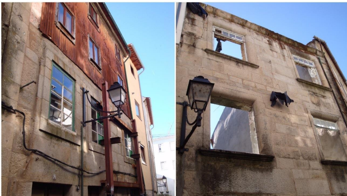
Figura 4.18: Estado avançado de degradação
