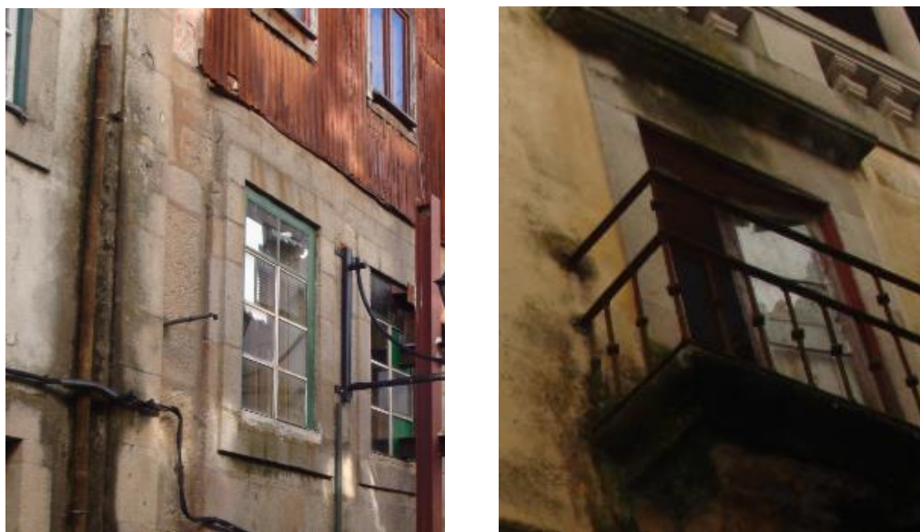
Figura 2.17: Corrosão dos elementos metálicos
