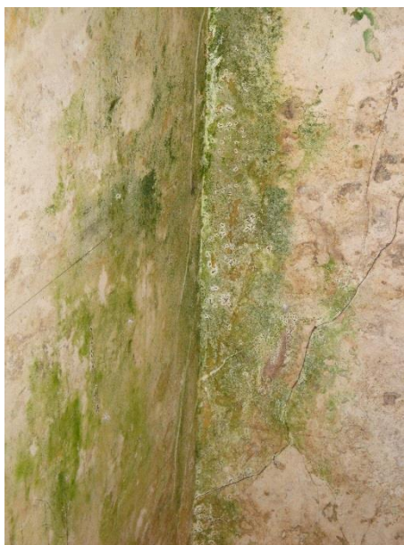
Figura 5.50: Bolors presentes nas paredes interiores
