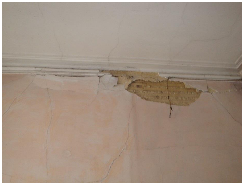
Figura 2.54: Fissura entre parede e teto
