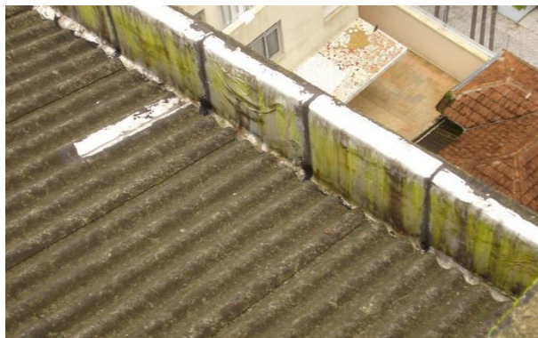
Figura 2.21: Infiltração através de platibandas
