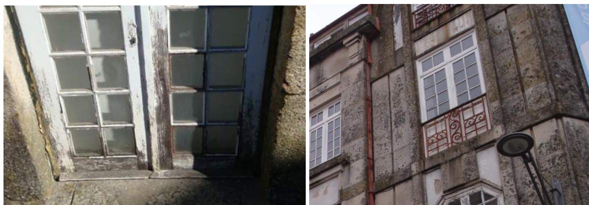
Figura 2.31: Diferença de cor à esquerda e oxidação de acessórios à direita
