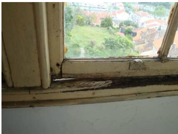
Figura 2.28: Perda de estanquidade à água e permeabilidade ao ar
