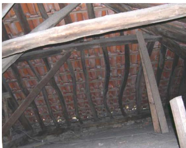
Figura 2.9: Deformação dos elementos de suporte
