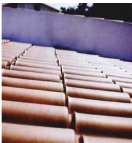
Figura 2.3: Sobreposição insuficiente das telhas
