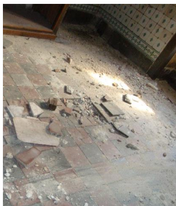
Figura 2.41: Fissuração do material cerâmico
