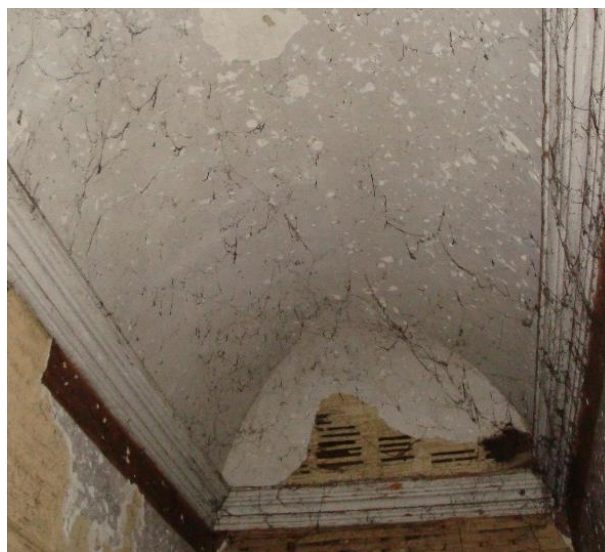
Figura 2.47: Degradação do material de revestimento e reboco
