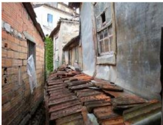
Figura 2.29: deformação da caixilharia
