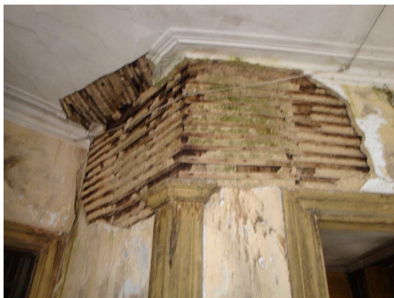
Figura 2.51: Degradação do material de suporte de paredes interior
