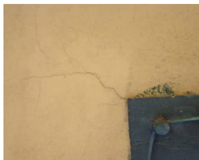
a) Fissuras nos cantos dos vãos
