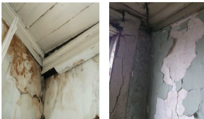
a) Degradação por fungos
