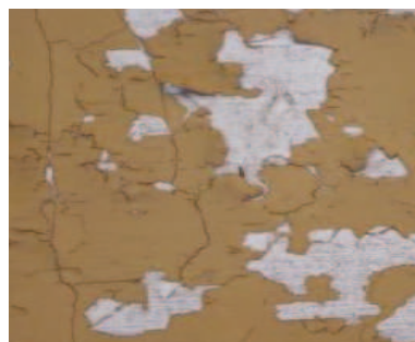
b) Destacamento do revestimento
