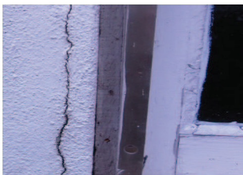
Figura 2-11: Fenda devido a diferentes materiais aplicados
