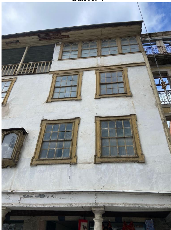
Figura 45 - Imagem frontal apresentando uma deformação visível de uma viga na “Casa dos Balcões”.
