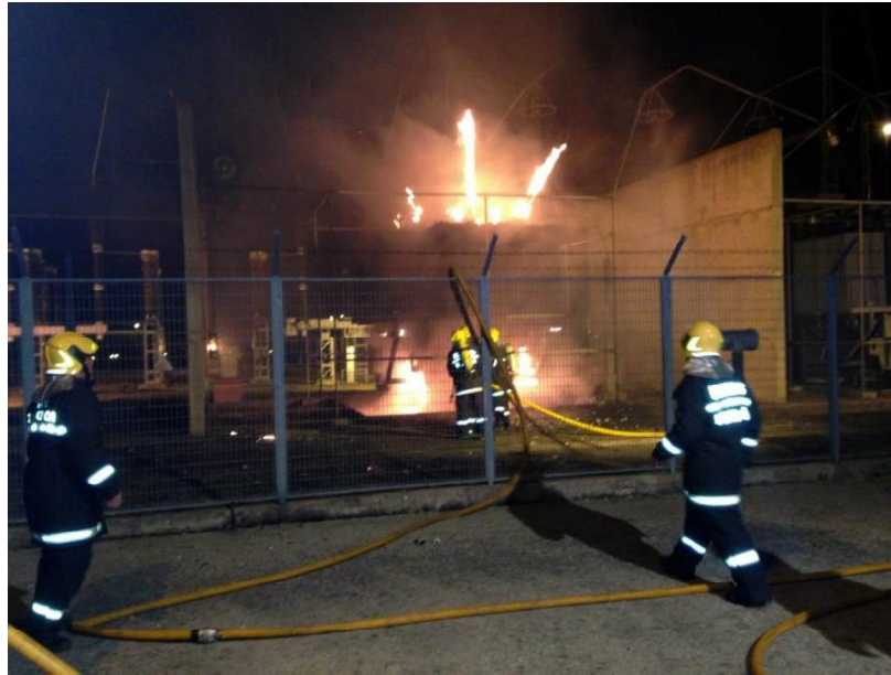
Figura 32: Incêndio em transformador da subestação da Barragem do Pocinho [67].
