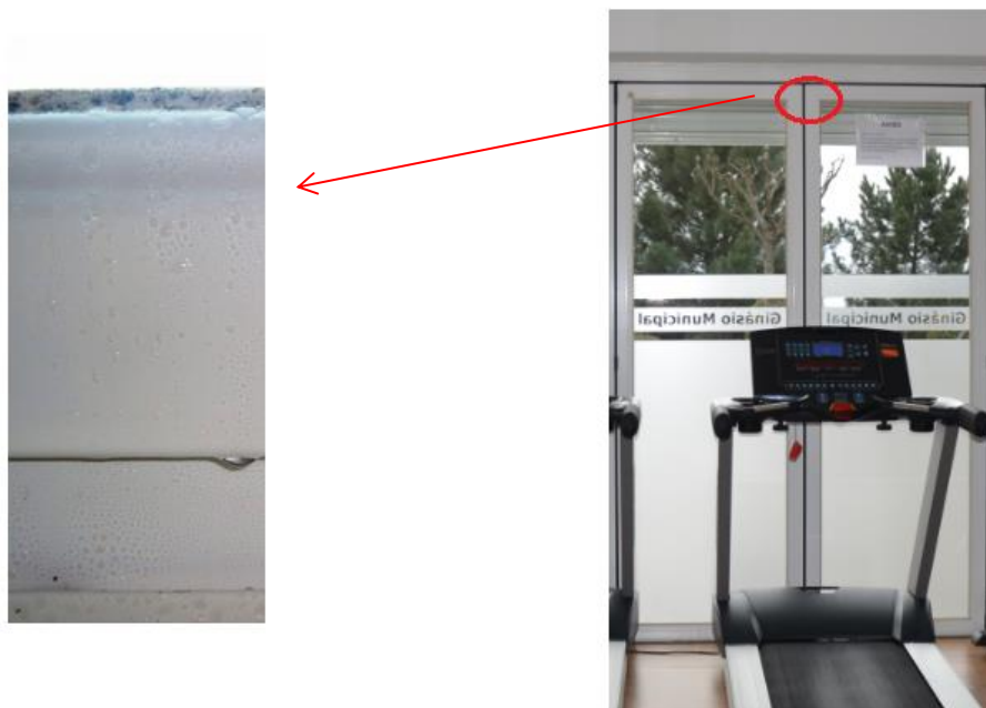
Figura 5-7: Condensações na caixilharia no caso de estudo 1
