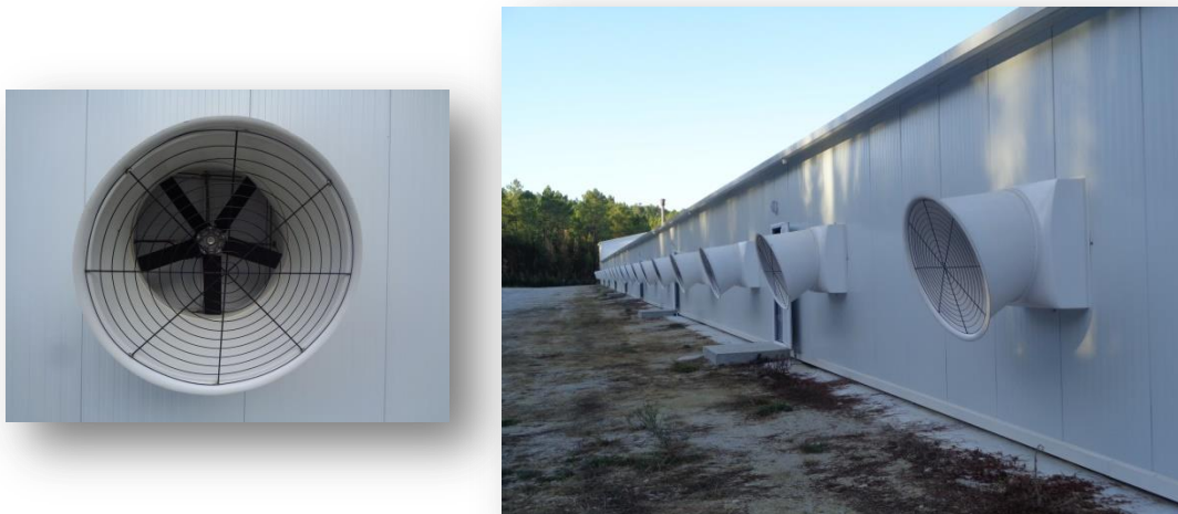
Figura 35: Ventiladores com grades de proteção.
