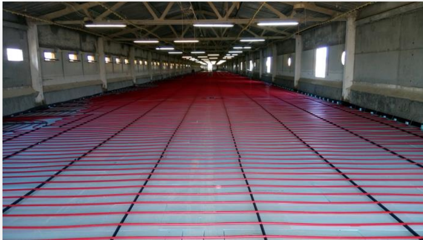
Figura 14: Aquecimento sob piso radiante.
