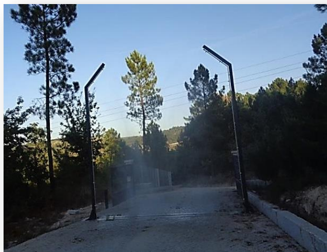
Figura 37: Arco de desinfeção (em funcionamento).
