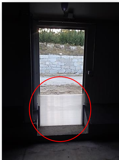
Figura 48: Porta lateral com proteção.
