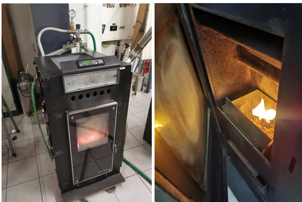
Figura 5.3 – Caldeira e zona da câmara de combustão.
