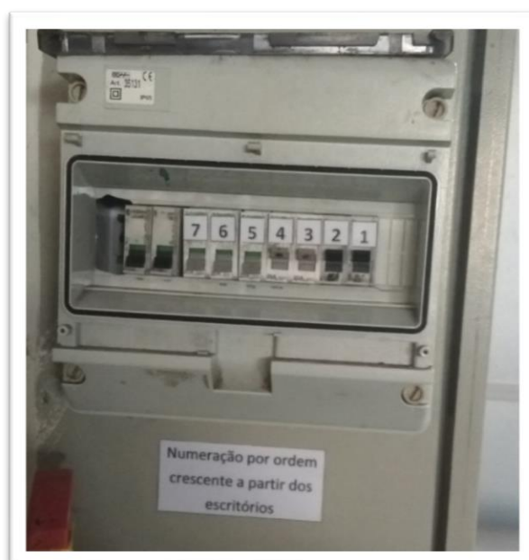
Figura 55 - Quadro da iluminação
