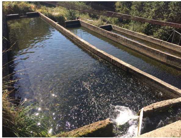
Figura 9. Redes de entrada dos tanques
