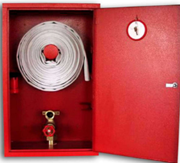
Figura 19 - Boca de Incêndio tipo teatro
