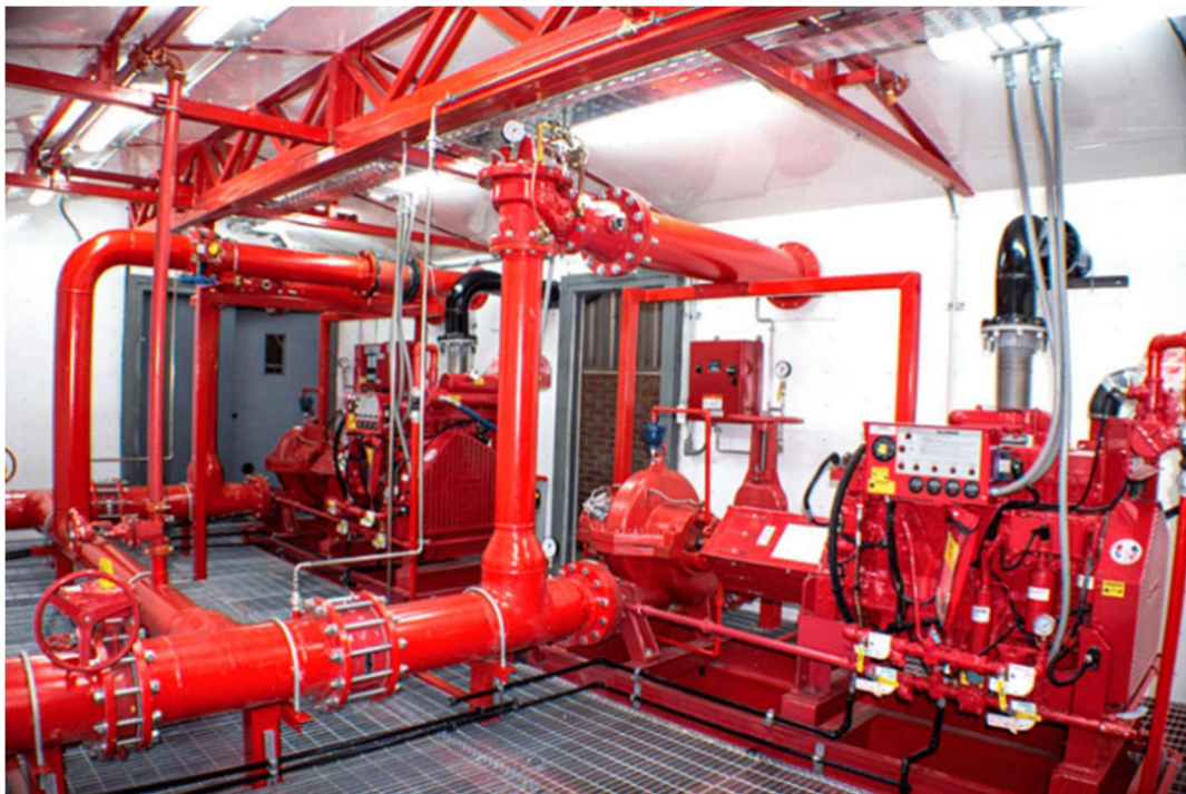
Figura 22 - Grupo de bombagem para redes húmidas
