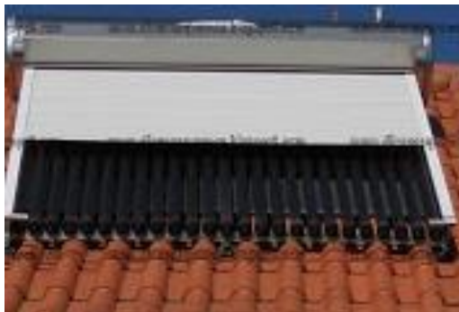
Figura 3-17: Painel solar com estore.
