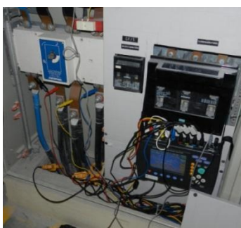
Figura 4-1: Medições realizadas no QGBT
