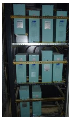
Figura 6-49: Bateria de condensadores de 475kVAr instalada na Cerutil
