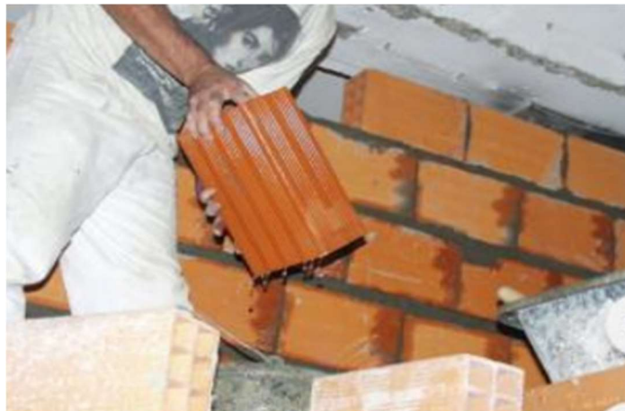
Figura 2 - Molhagem em excesso dos tijolos
