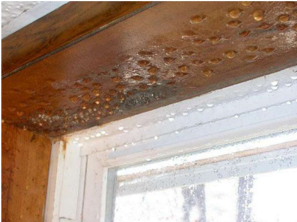
Figura 5 - Humidade de condensação
