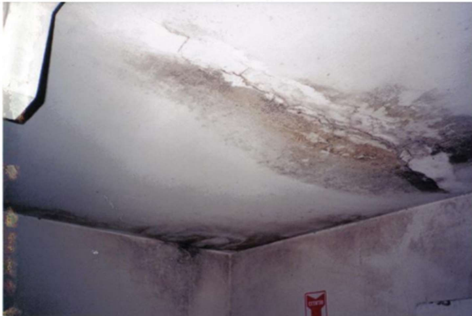
Figura 15 - Infiltração nas paredes proveniente da cobertura
