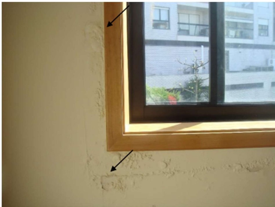
Figura 13 - Fenómeno da Humidade por Infiltração
