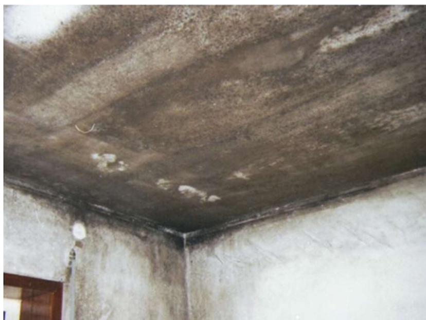
Figura 3- Manchas de bolor que devido ao fenómeno de condensações superficiais
